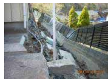
【危険(赤): 擁壁の崩落状況】
