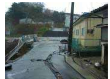
【危険(赤): 前面道路の崩落状況】
