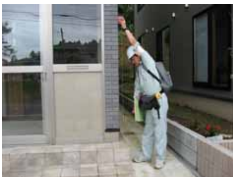
建物の傾斜を計測
