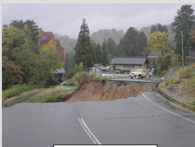
陥没した道路
