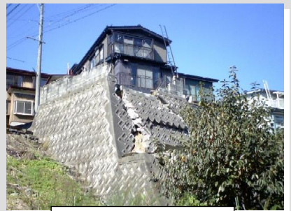
間知石積擁壁の被害
