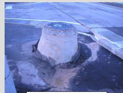
隆起したマンホール
