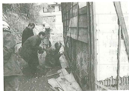
A棟筋違いの破断状況を確認される先生方
