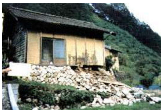
住宅直下の石垣の崩壊
