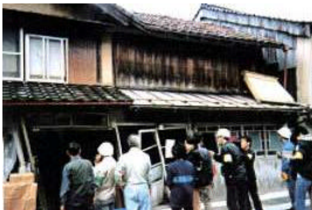
町屋の被害・開口部の多い1階の傾き
