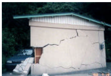
坑火石造の壁が被災した住宅
