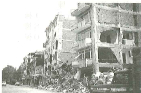
穴明き煉瓦の壁が落下し、傾斜している共同住宅
