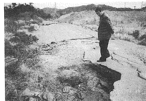
写真2 ゴルフ場造成用道路、右肩が50cm位持ち上っている 陥落部をのぞいているのが筆者
