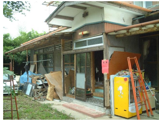
■危険(前面に傾斜) 鹿島台町
