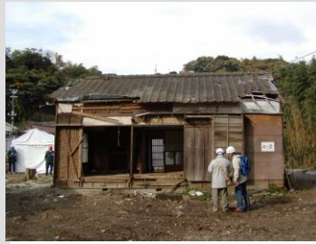
④ 外観からの被害状況
