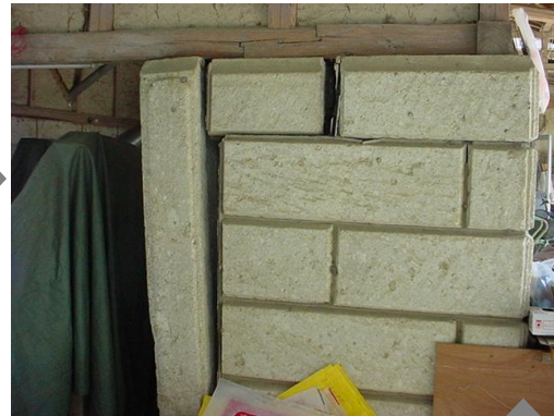
小屋組のアンカーを石で挟んだだけの固定
