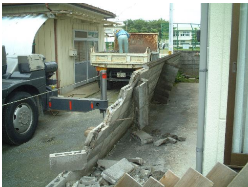
■ブロック塀の倒壊
