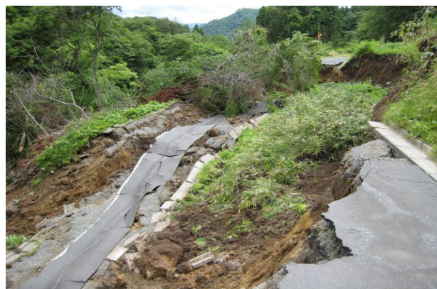
(栗駒沼倉地区 寸断された道路)
