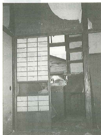
B棟内壁の剝落
