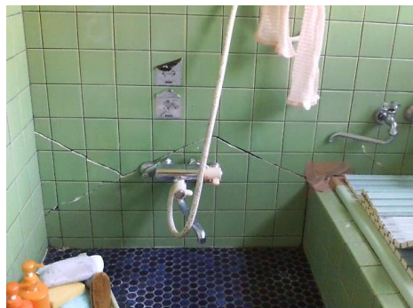
写真3 半壊した住宅の被害
