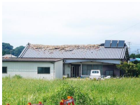
写真1 住宅の屋根瓦被害
