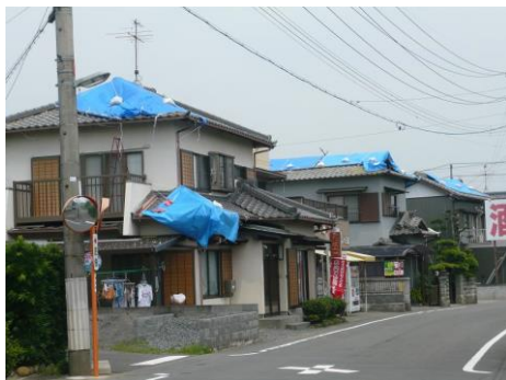
写真2 住宅の屋根瓦被害
