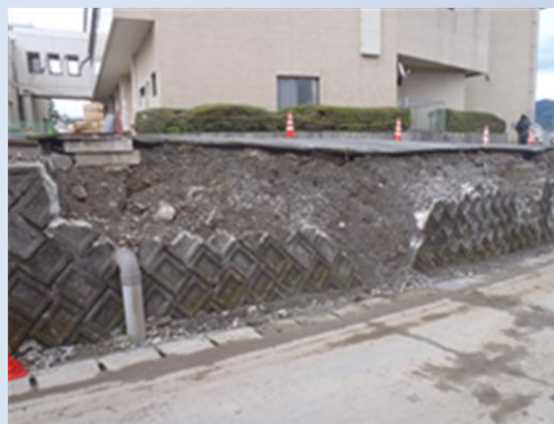
○土留めの崩壊
