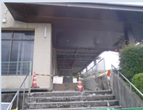
○天井部材の崩落
