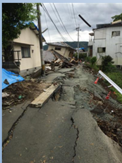
○家屋・道路の崩壊
