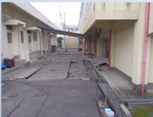
○通路部分の損傷
