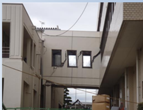
○渡り廊下の損傷
