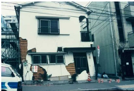
壁の被害及び外装材 (Cランク)
