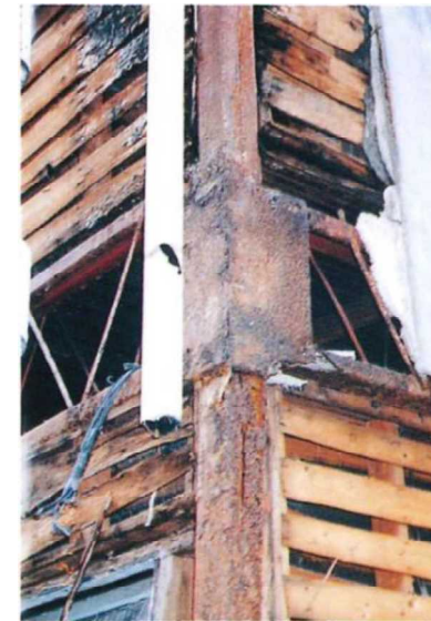
腐食が進行した鉄骨部材
