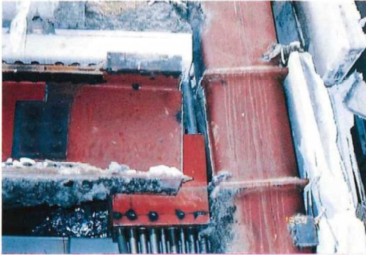
柱-梁接合部の損傷
