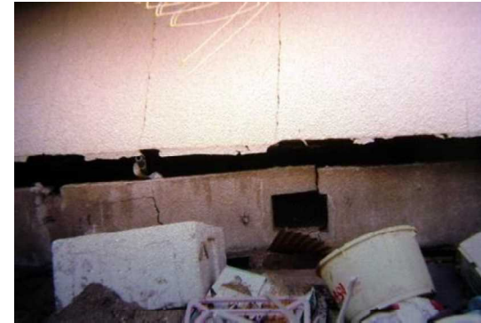
基礎の被害 (Cランク)
