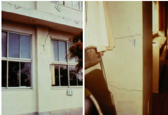
損傷度Ⅲ (斜めのせん断ひび割れ)
