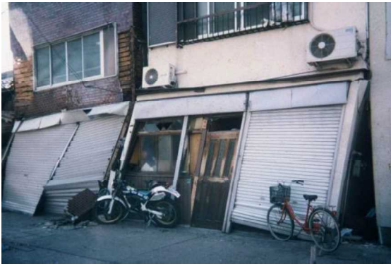
建築物1階 の傾斜 (Cランク)
