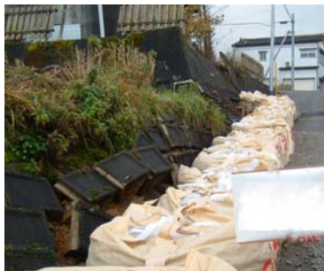
土嚢積みによる擁壁崩壊の抑制
