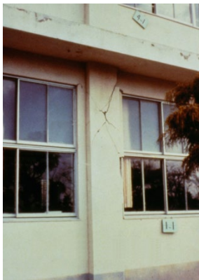
損傷度Ⅲ (斜めのせん断ひび割れ)
