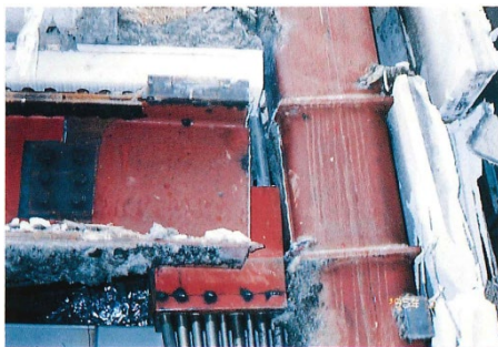
柱－梁接合 部の損傷
