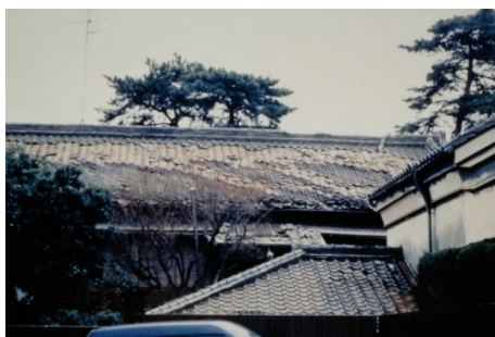
屋根瓦 (Cランク)
