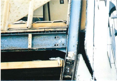
柱－梁ボルト接合部で柱が座屈し、ボルトも外れている。
