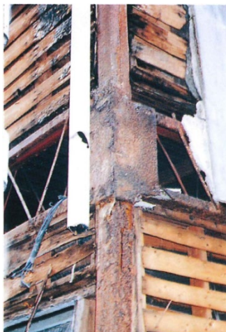
腐食が進行した鉄骨部材
