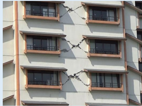
【せん断ひび割れ】
