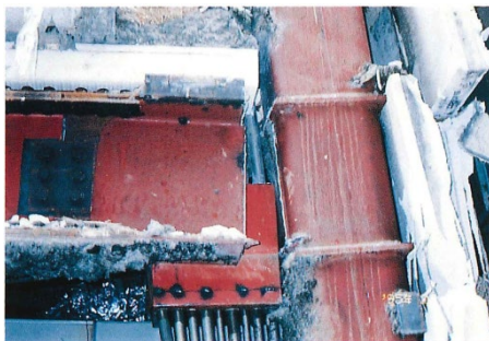
柱－梁接合 部の損傷
