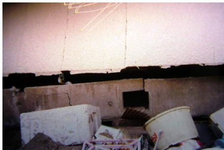
基礎の被害 (Cランク)
