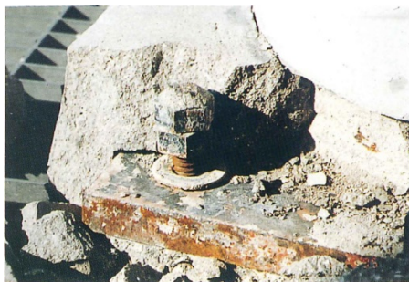
露出形柱脚 のアンカー ボルトの抜 け出し
