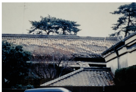
屋根瓦 (Cランク)
