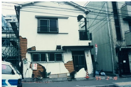
壁の被害及 び外装材 (Cランク)
