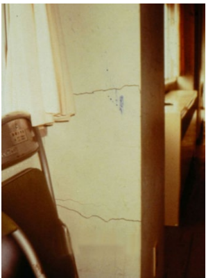
損傷度Ⅱ (水平の曲げひび割れ)
