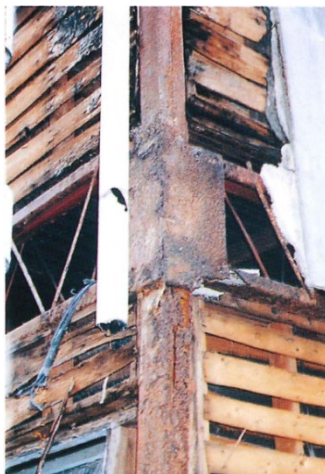
腐食が進行した鉄骨部材
