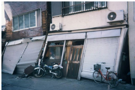
建築物 1 階 の傾斜 (Cランク)
